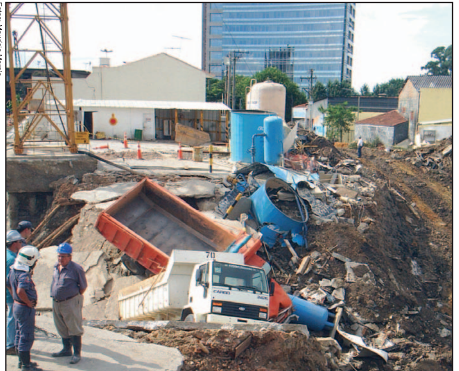
Cratera aberta no local da obra da Linha 4 - Amarela, até hoje sem explicação
